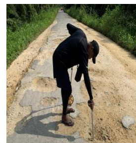
Gambar 5. Kerusakan Jalan Pada STA 0+400-0+700
