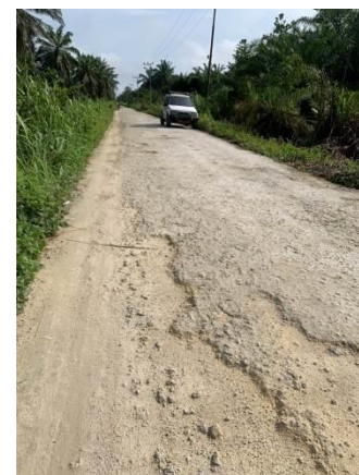
Gambar 4. Kerusakan Jalan Pada STA 0+100-1+400
