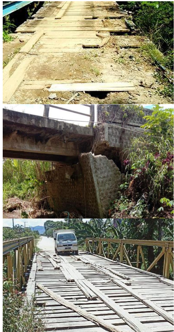
Gambar 1. Contoh Kerusakan Jembatan Sumber: Google, diakses Mei 2023
