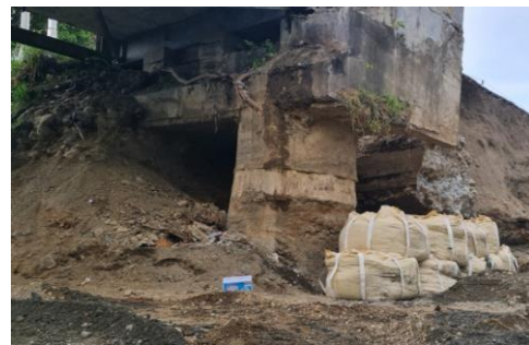
Gambar 6. Gerusan Pada Sisi Depan Abutmen Sumber: Dokumentasi Lapangan, 2023
