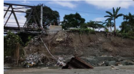
Gambar 5. Gerusan Pada Sisi Jalan Pendekat Sumber: Dokumentasi Lapangan, 2023
