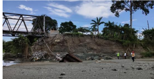
Gambar 3. Kerusakan Jembatan Bumi Wonorejo Akibat Banjir
