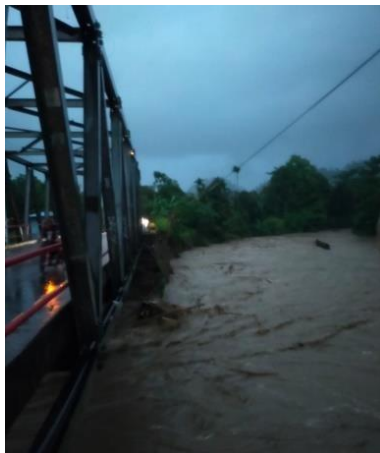
Gambar 2. Kondisi Jembatan Bumi Wonorejo Saat Banjir
