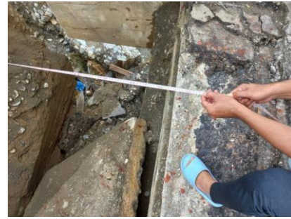
Gambar 8. Kondisi pada Depan Abutmen yang Mengalami Gerusan ke Dasar
