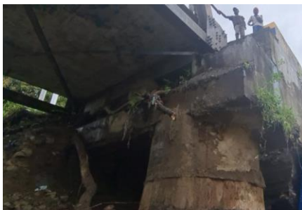
Gambar 7. Lubang pada Sisi Depan Abutmen Akibat Gerusan
