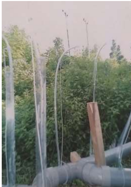
Gambar 7. Pipa kapiler yang dipasang pada sistem untuk mengukur tekanan statis
