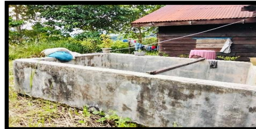
Gambar 5. Bak Penampungan Air Bersih Sumber: Survei Primer, 2025
