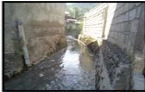
Gambar 5. Penyempitan Saluran Drainase
