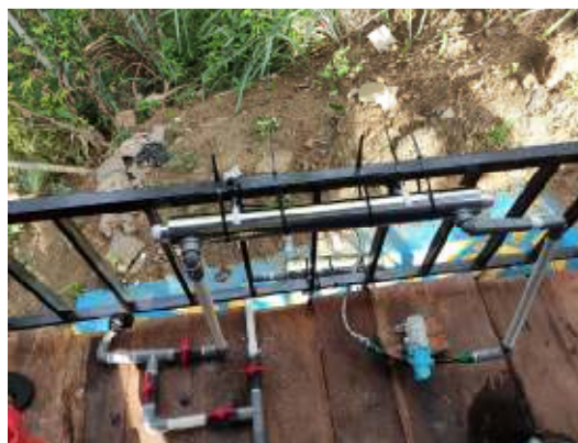
Gambar 2. Instalasi unit pengolahan air minum terpasang
