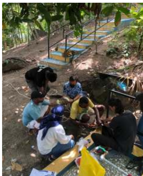
Gambar 3 (b) Pemasangan otomatisasi kelistrikan
