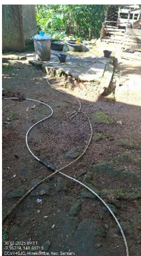
Gambar 1. Instalasi Air Bersih Pada Rumah Warga Kampung Sereh
