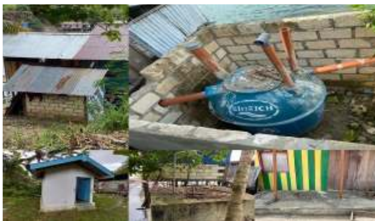
Gambar 2. Septictank Fiberglass yang sudah tidak berfungsi
