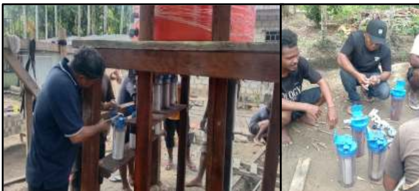
Gambar 5 : Instalasi Jaringan Air Bersih
