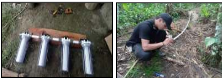
Gambar 5 : Instalasi Jaringan Air Bersih
