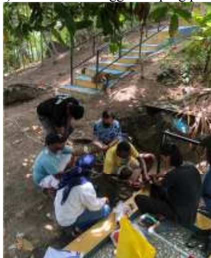
Gambar 3 (b) Pemasangan otomatisasi kelistrikan
