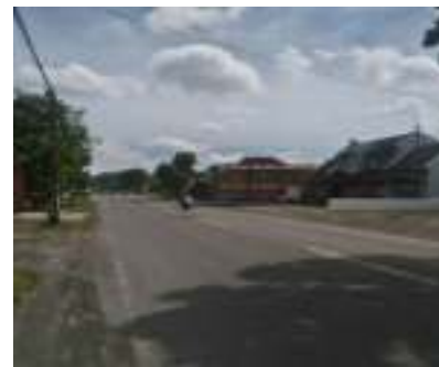
Gambar 5. Beda Tinggi Badan Jalan dan Sisi Luar Badan Jalan
