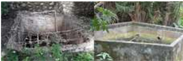
Gambar 4. Bak Penampungan Air Yang Tidak Terawat dan Tidak Berfungsi
