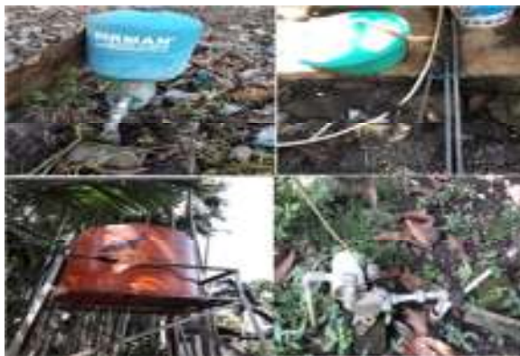
Gambar 6. Mesin Pompa Air Tanah, Tandon Penampungan dan Pipa Saluran
